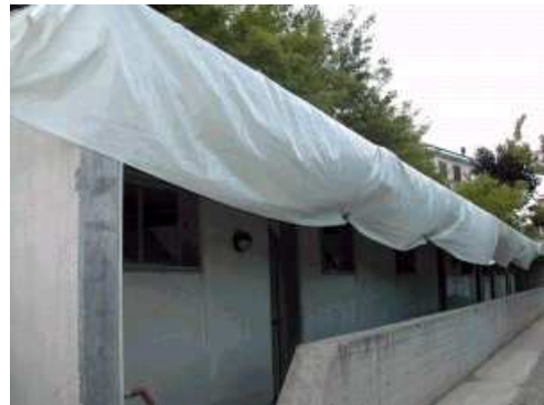
ecco come si presentavano gli spogliatoi prima dei lavori con il telone sul tetto a causa delle infiltrazioni d'acqua
