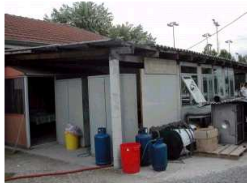
La situazione precaria delle strutture della polisportiva che necessiterebbe di una sistemazione generale.
